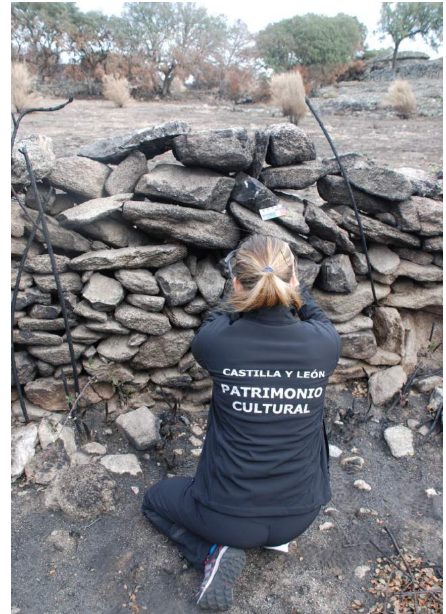
Técnico de patrimonio valorando los daños provocados por un incendio
